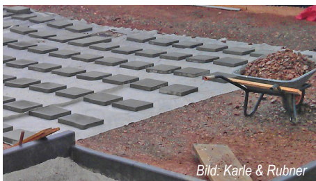
Abb. 13 Die Betonplatten dienen zur Lastverteilung auf den Unterbau. Setzungen werden so reduziert.
