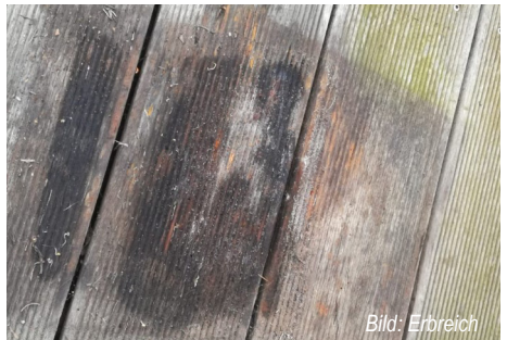
Abb. 28 „Abdruck“ eines Blumenkübels der direkt auf den Dielen stand. Hier verbleibt eine erhöhte Holzfeuchte mit der Gefahr von Fäulnis.
