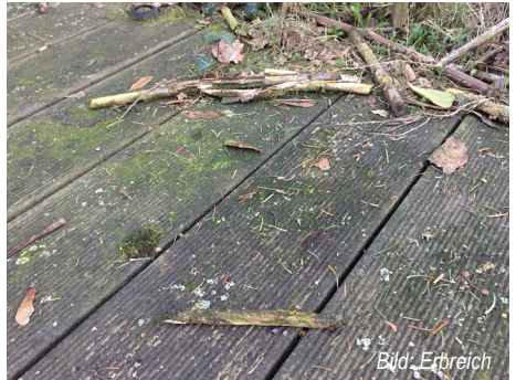
Abb. 27 „Feuchtenester“ durch Verschmutzungen sollten vermieden werden.
