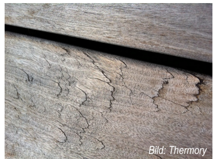
Abb. 6 Diele mit Schilfer und Absplitterung.
