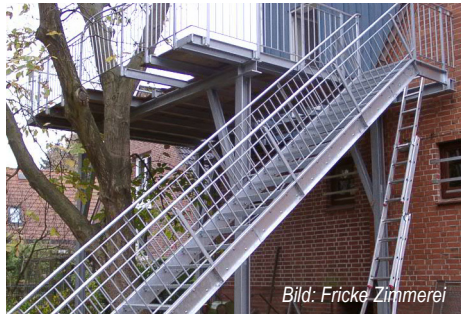
Abb. 15 Holz-Stahl-Konstruktionen sind sehr beliebt. Eine gute Abstimmung zwischen den Gewerken ist dabei notwendig.
